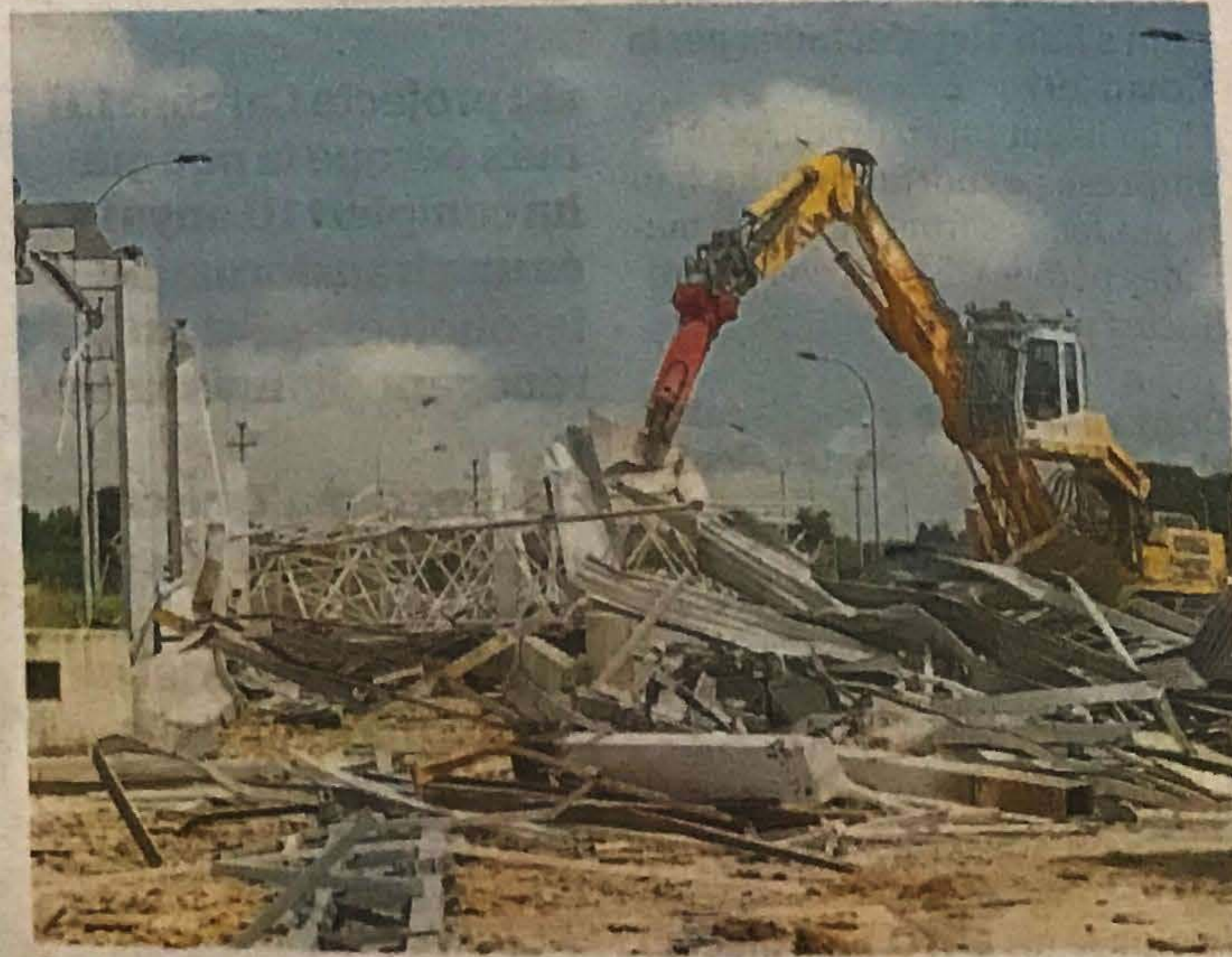
Enderroc de la marquesina de la sortida Tortosa-l'Aldea. FOTO: J. REVILLAS
