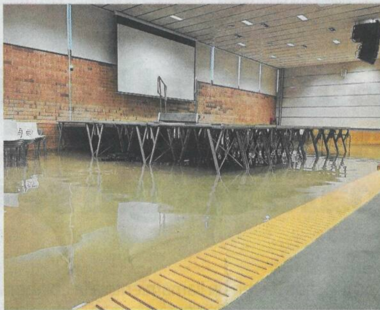
L'auditori municipal d'Amposta, inundat. FOTO: AJUNTAMENT D'AMPOSTA
