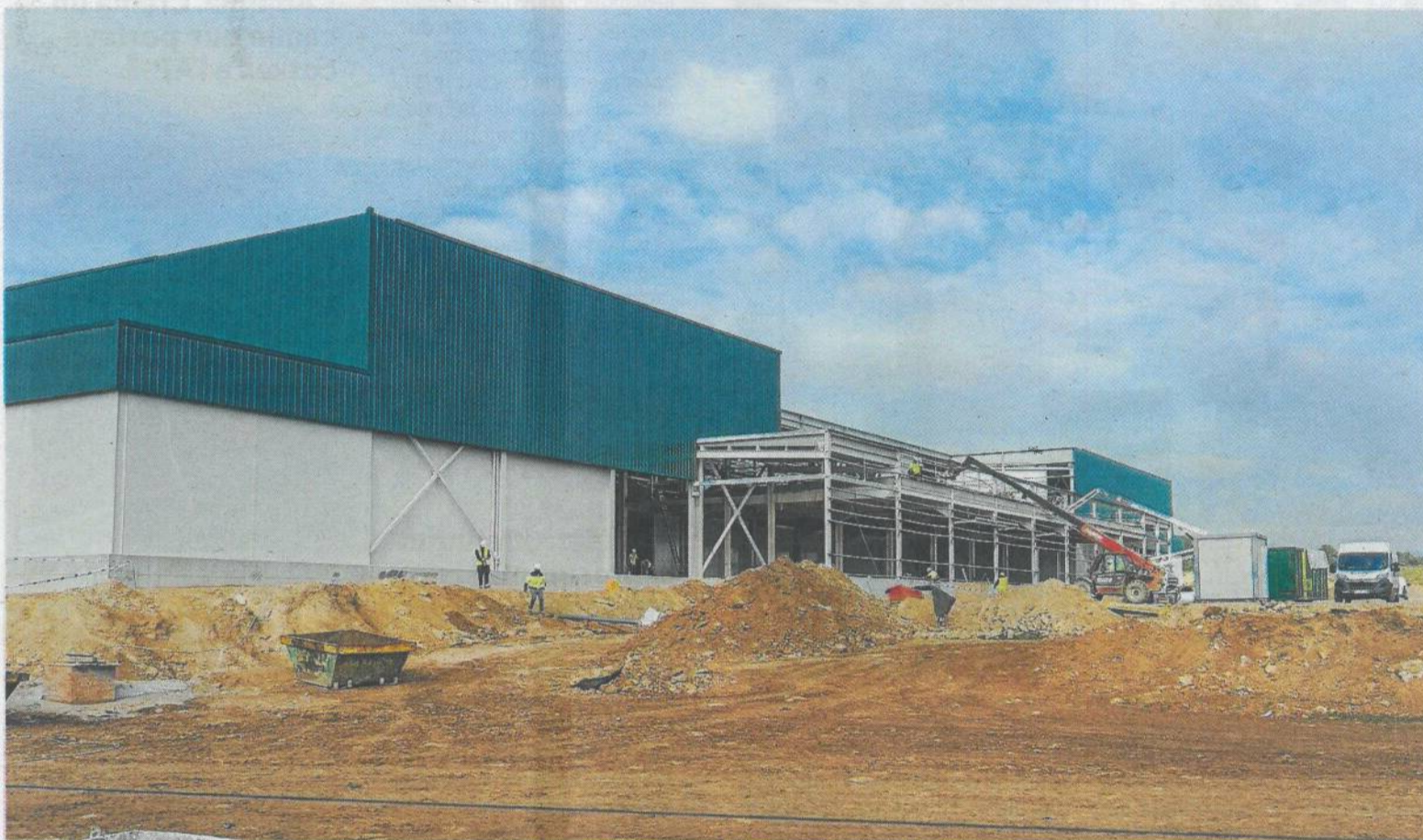
Les obres de la planta de producció de Florette al polígon Catalunya Sud. FOTO: JOAN REVILLAS
