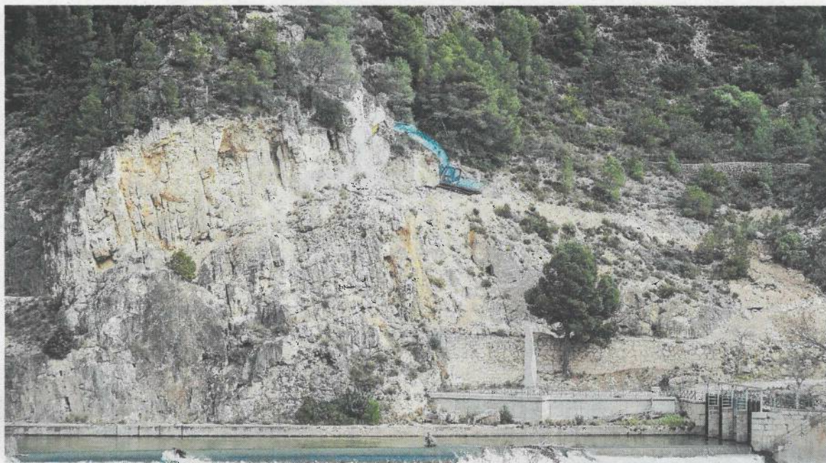
Detall de la màquina excavadora treballant a la zona, fa pocs dies. FOTO: JOAN REVILLAS
