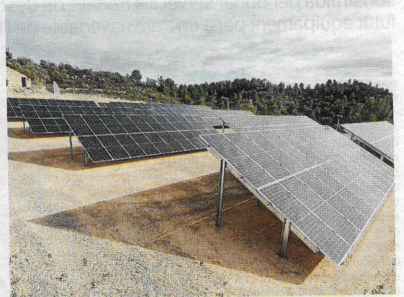
Planta fotovoltaïca de la Comunitat de Regants. FOTO: JOAN REVILLAS
